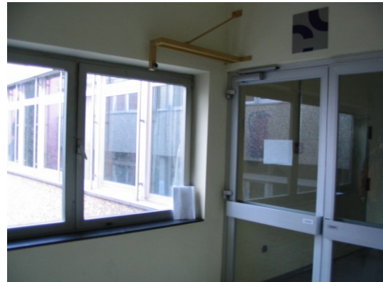
Bild 07: RD-Tür mit Feststellanlage
