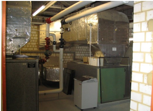
Bild 02: Technikraum ohne Brandlast
