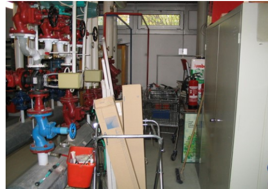
Bild 03: unzulässiges Lager im Technikraum
